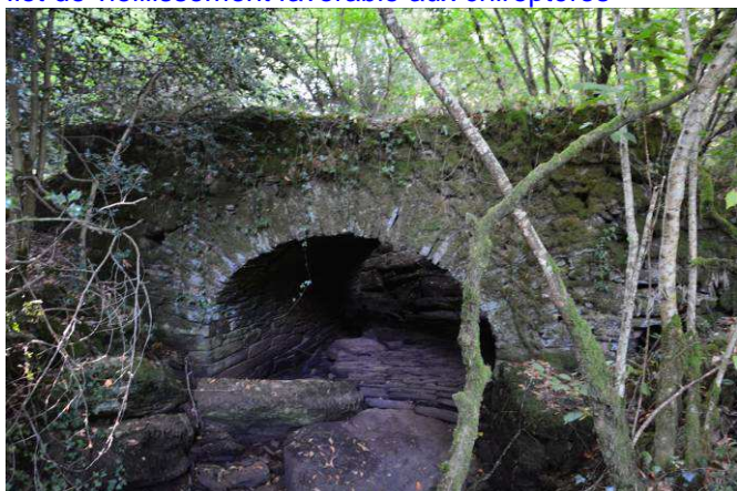
Pont avec fissures favorable à l'hibernation des murins
